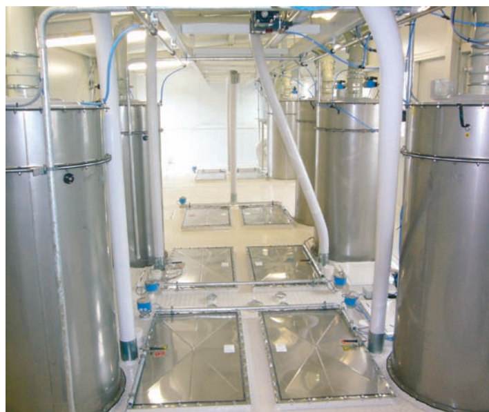
Abb. 5: Neue Silodecke mit Berstscheiben und Aufsatzfilter
