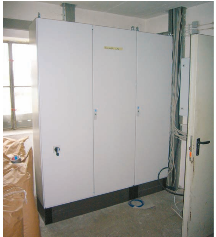
Abb. 14: Neuer Leistungsteil der neuen Steuerung
