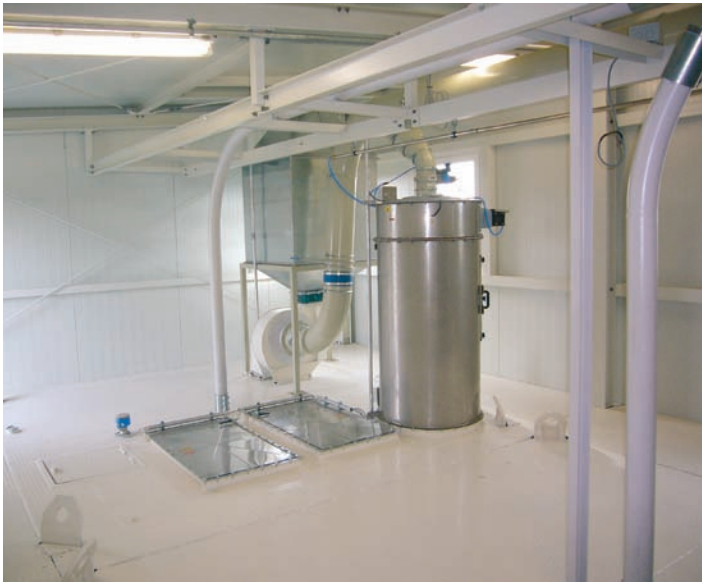
Abb. 6: Zentralventilator für alle Aufsatzfilter mit Schalldämpfer
