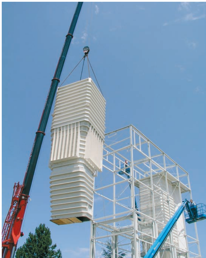
Abb. 4: Kleiesilo mit Spezialtrichter bei der Montage
